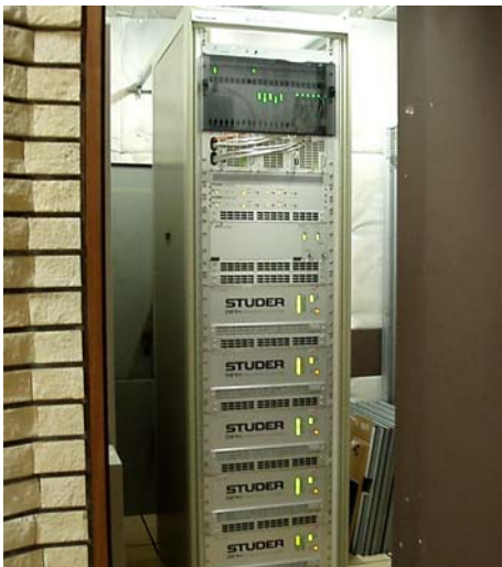
■マシンルーム内のVISTAラック
