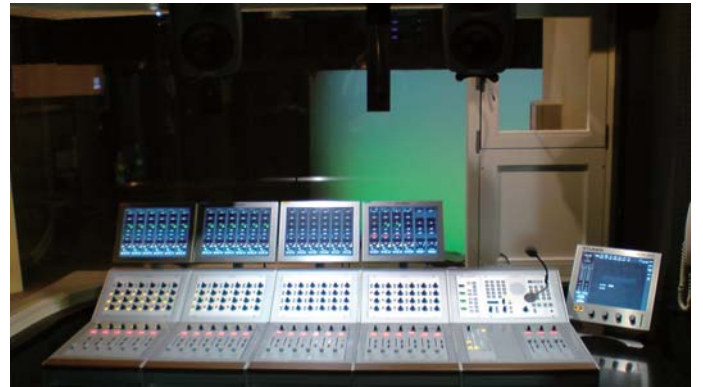
■ PA コンソール（音響室での使用例）
